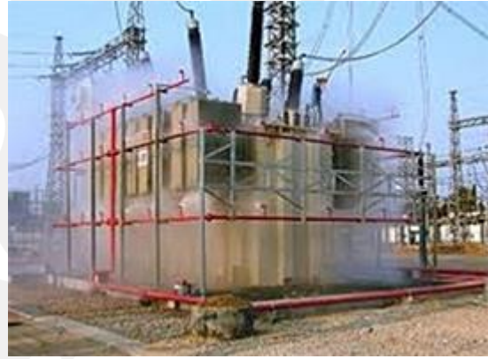
Trafo Su Spray Soğutma Sistemi
